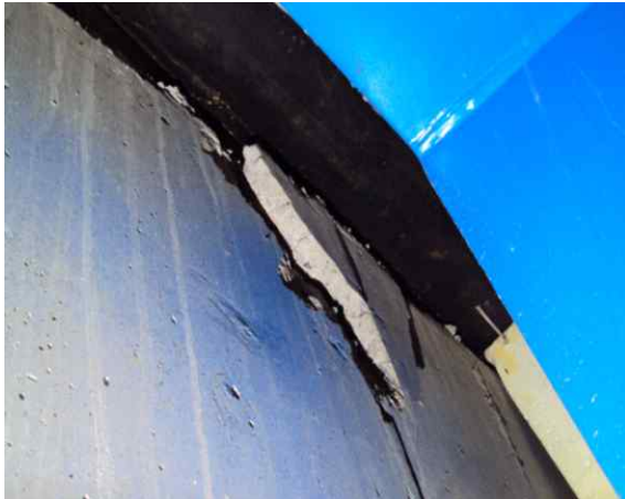
A2 흥벽 파손
